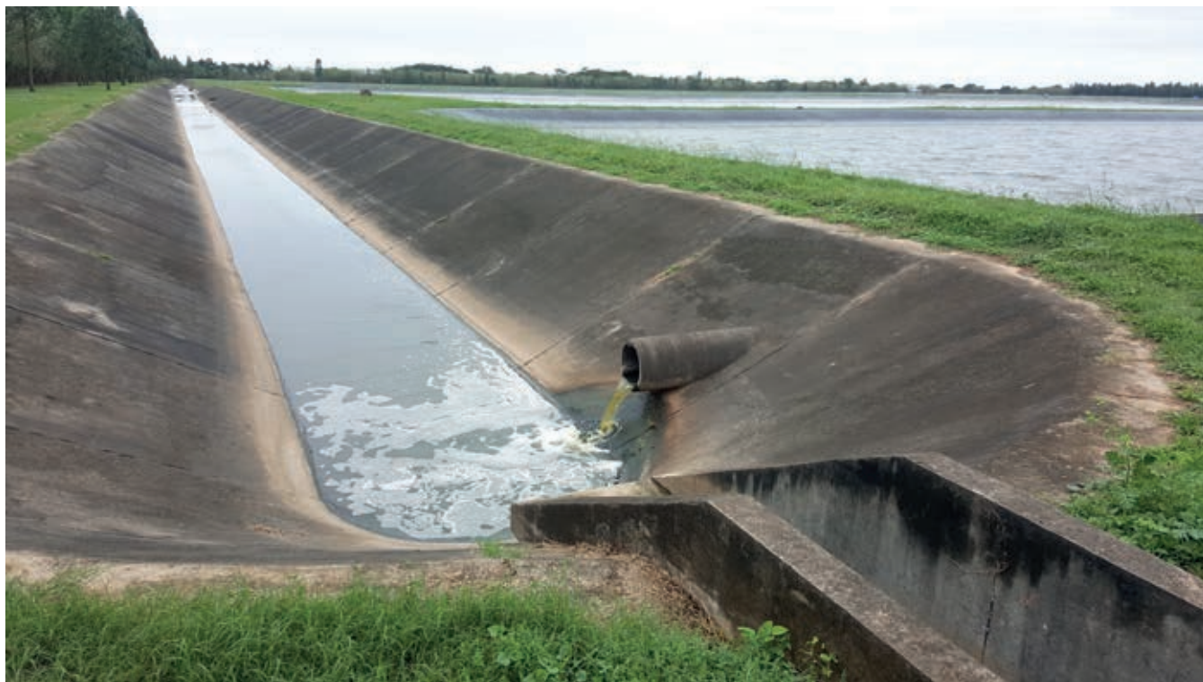
Canal del Efluente y Lagunas de Maduración PTAR COOPAGUAS (Santa Cruz)
